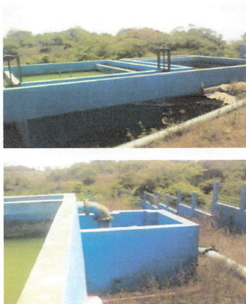
Gambar 4.5. Instalasi Pengolahan Air (Dokumentasi, 2011)
