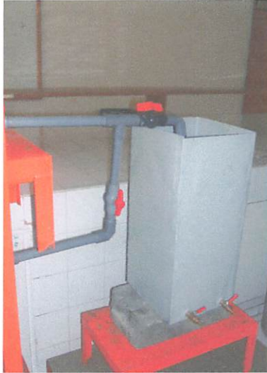
Gambar Bak Effluent
