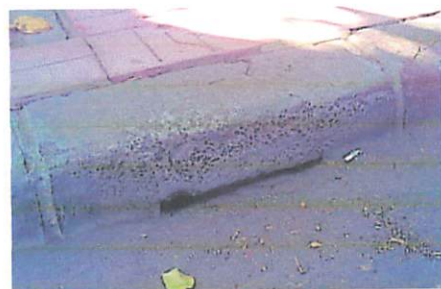
Gambar 6.6. Penyumbatan Street Inlet
