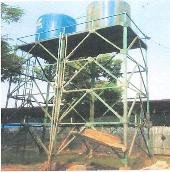
Gambar Tempat Penampungan Air Dari Dalam Tanah Di Pasar Induk Kramat Jati
