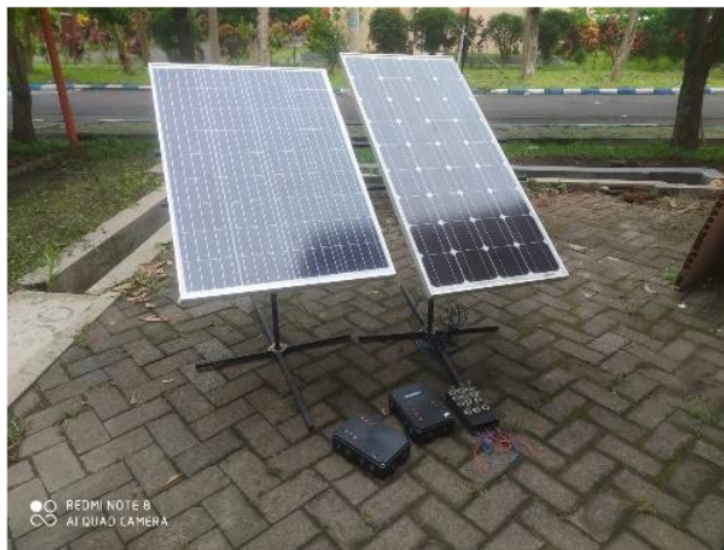
Gambar 7 – Peletakan Panel Surya, Datalogger, dan Dummy Load
