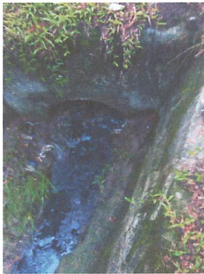
Gambar 4.5 Kondisi outlet pembuangan limbah domestik Kecamatan Balikpapan Selatan
