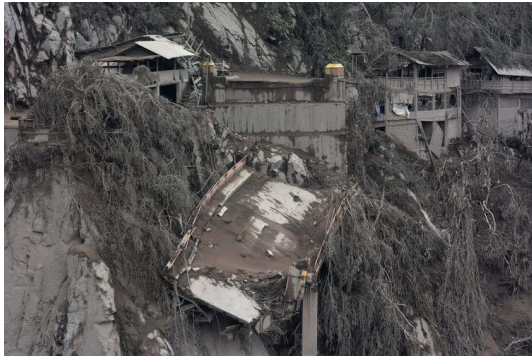
Gambar 3. 3 Kondisi Jembatan yang Telah Rusak (Sumber: www.google.com )
