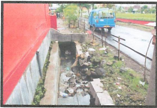
Gambar 4.15 Saluran pembuangan air Sumber : Survey Lapangan, 2013
