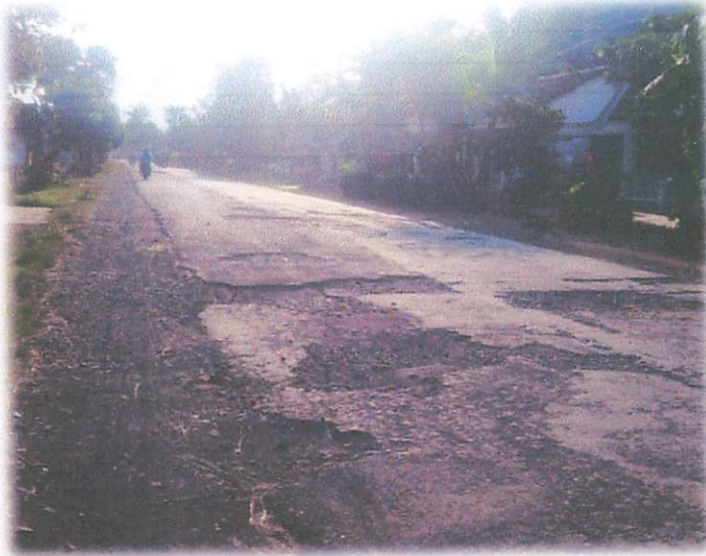
Gambar 4.2 Kondisi Jalan Kabupaten Di Kecamatan Kencong
