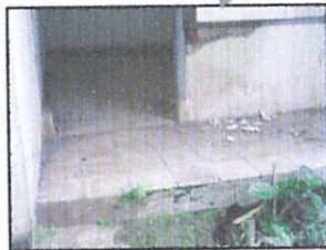
Kondisi lantai semen
