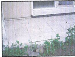
Kondisi lantai keramik
