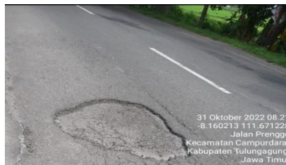
Gambar 1.1 Contoh Kerusakan Lubang
