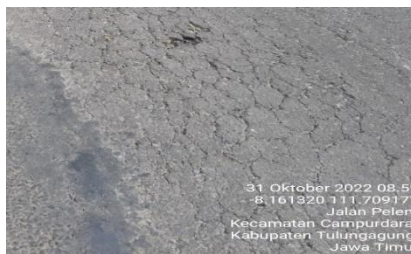
Gambar 1.2 Contoh Kerusakan Retak Kulit Buaya
