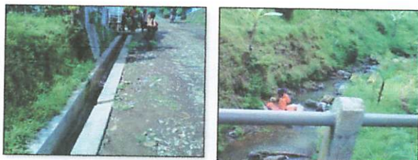
Gambar 4.10. Kondisi Drainase Di Jalan Utama Desa Palangsari Sumber : Hasil Survey dan Hasil Rekapitan
