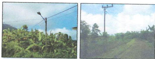
Gambar 4.13. Kondisi Jaringan Listrik Desa Palangsari Sumber: Hasil Survey dan Hasil Rekapitan
