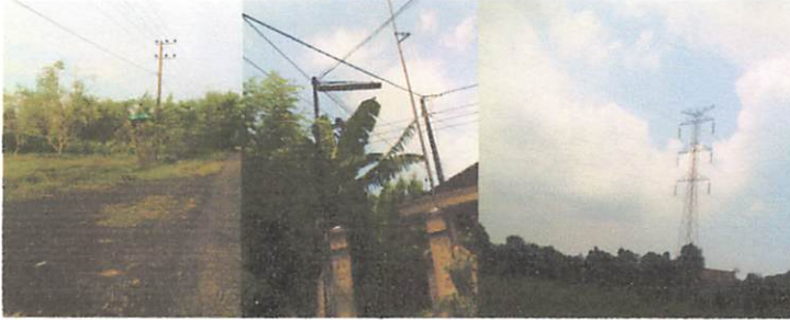
Foto 2.6 Jaringan Listrik SUTM & SUTR Sumber : Hasil Survey
