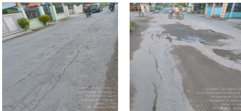
Gambar 1.1 Bentuk Kerusakan Pada Jalan Tarik – Jalan Kedung Bocok
