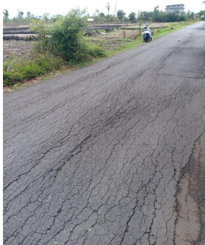
Gambar 1.1 Contoh kerusakan jalan pada ruas Jalan Raya Pengembur
