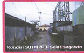
Kondisi SUTM di Jl Selat-sagawin
