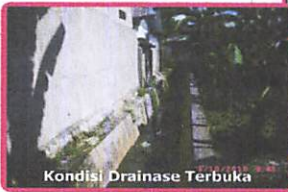
Kondisi Drainase Terbuka
