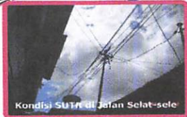
Kondisi SUTR di Jalan Selat-sele
