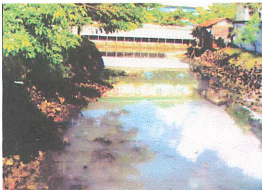
Gambar 5.7. Kondisi Drainase di Pasar Gamalama
