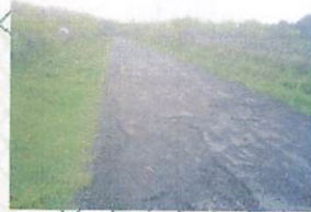
Jalan menuju kawasan wisata perlu peningkatan kondisi dengan aspal baik
