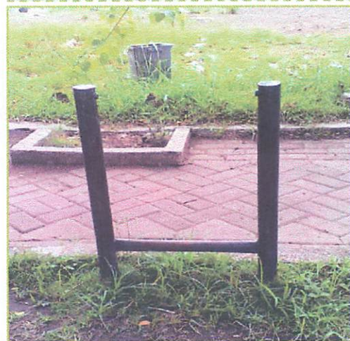
Gambar 4.17 Tempat sampah yang sudah rusak
