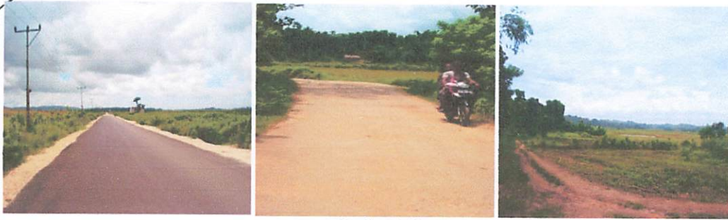
Gambar 1.11 Jenis Perkerasan Jalan di Kab.Sumba Tengah Sumber : Hasil Survey 5 Januari 2010
