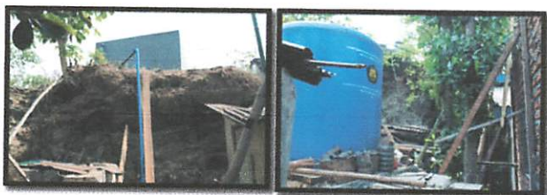
Gambar 4.2 : Kondisi SPAM di Desa Kabuh
