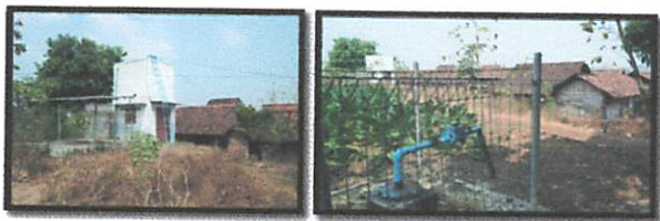
Gambar 4.1 : Sumur Bor dan Tower di Dusun Kwacan
