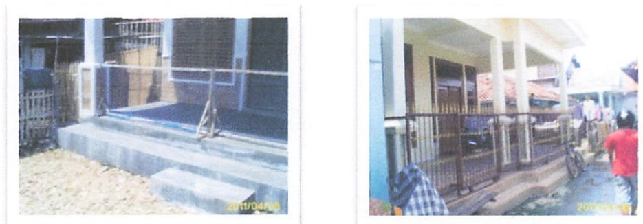
Gambar 4.4. Kondisi Lantai Rumah
