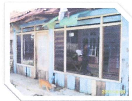
Gambar 4.9. Kondisi ventilasi yang Tidak memadai
