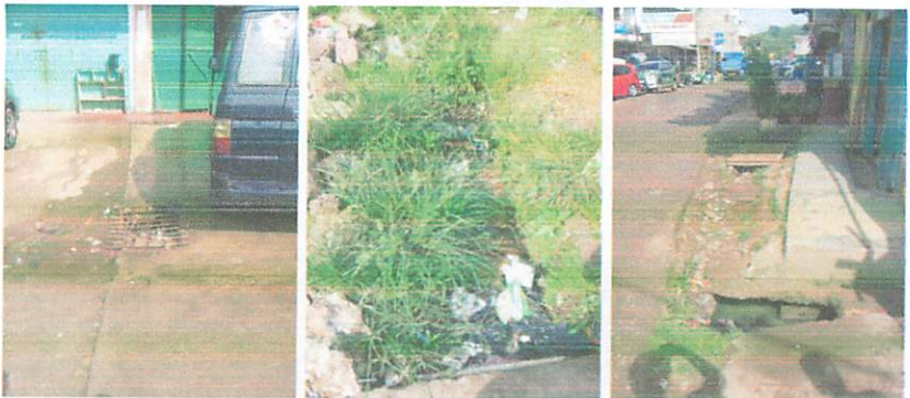
Gambar 4.11 Kondisi Drainase di Pasar Bolu
