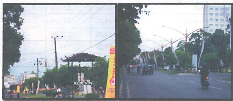
Gambar 4.3 kondisi jaringan listrik di Kota Palangka Raya
