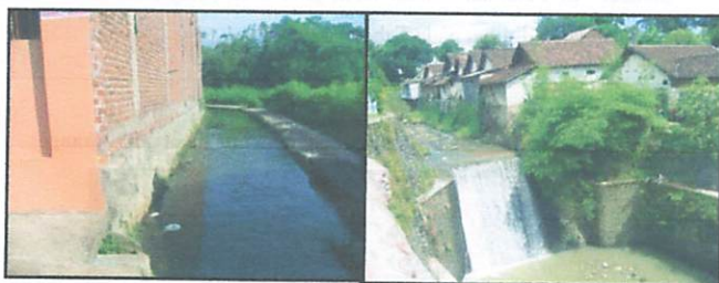
Gambar 4.11 Kondisi Jaringan Drainase dan Pematusan di Perkotaan Lawang
