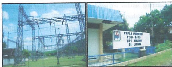
Gambar 4.9 Kondisi Jaringan Listrik di Perkotaan Lawang
