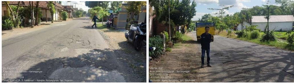
Gambar 1.1 Kondisi kerusakan pada ruas Jalan Kedunglurah – Karanganyar di Kabupaten Trenggalek
