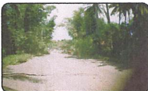
Kondisi jalan aspal rusak mengakibatkan terjadinya pencemaran debu
