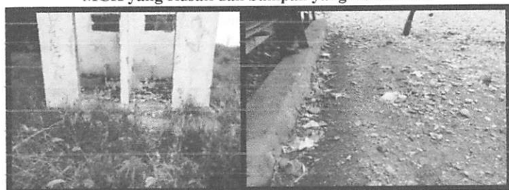
Gambar 5.5 MCK yang Rusak dan Sampah yang Berserakan
