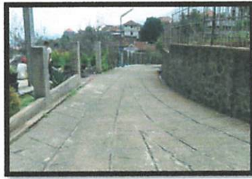
Gambar 4.2. Kondisi Jalan Beton Kampung
