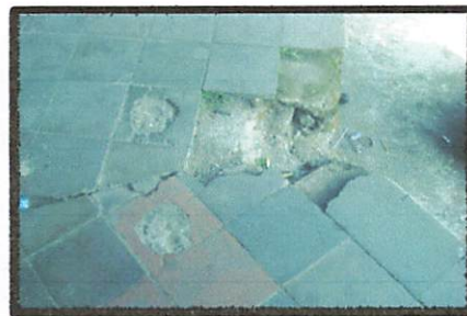
Gambar 4.51 Salah satu lantai rusak di ruang tunggu Angkutan kota
