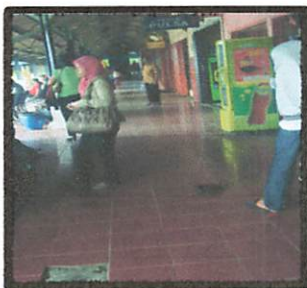
Gambar 4.50 Salah satu lantai rusak di ruang tunggu
