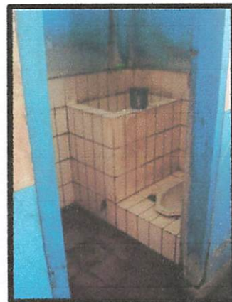
Gambar 4.31 Kondisi Toilet di tempat tunggu penumpang AK dan ADES
