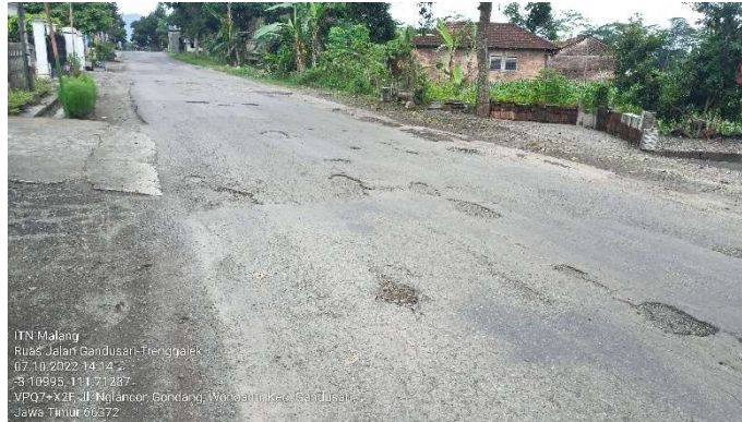
Gambar 1.1 Kerusakan Jalan Ngetal-Kebon STA 2+600
