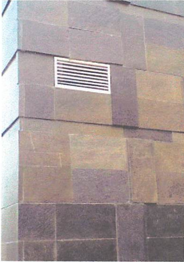
Gambar 2.8 Ventilasi hanya ada pada tempat tertentu yang membutuhkan udara keluar masuk ruangan. Kebanyakan ruangan tidak terdapat ventilasi. Karena adanya pendingin ruangan (AC)
