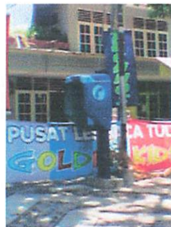
Jaringan telepon pada site
