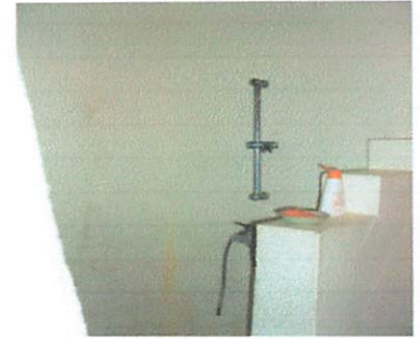
Shower di ruang spa
