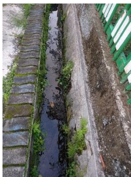
Gambar 20 Saluran Drainase Standar dengan Perkerasan
