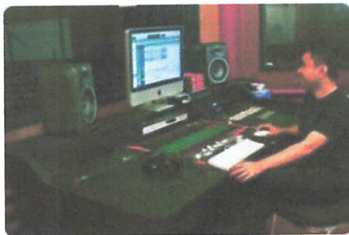
Gambar 4.8. Ruang Kontrol pada studio rekaman
