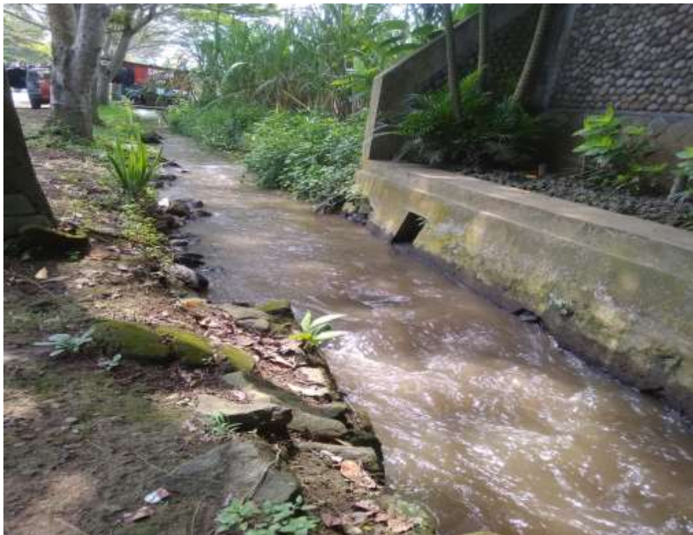
Gambar kondisi saluran rusak
