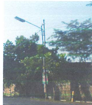
Gambar 4.7: Lampu Penerangan Jalan
