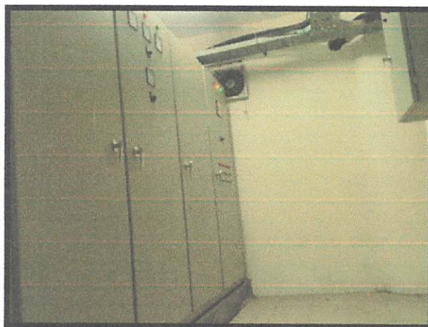
Gambar 2.1.28. Ruang Panel (sumber : Dokumen Pribadi)
