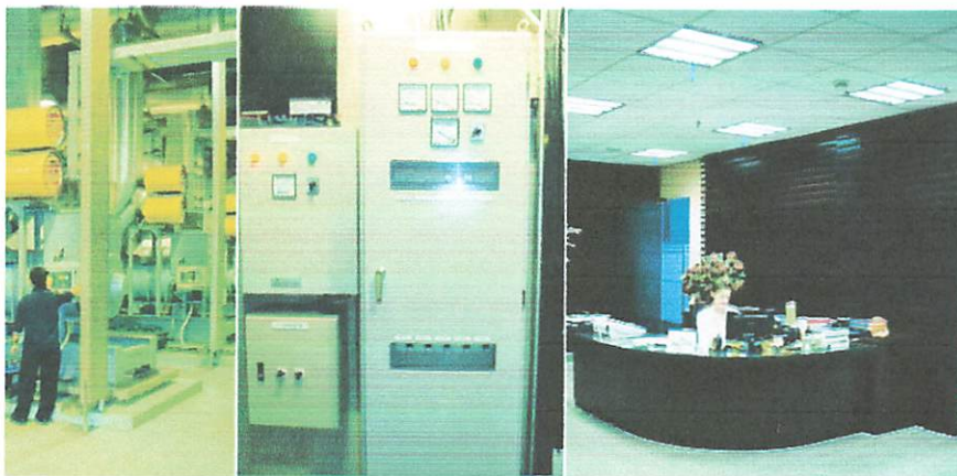
Gambar 2.1.2.14. Elektrikal apartemen grand palace
