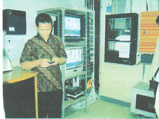
Didalam ruang control terdapat penjaga untuk selalu mengontrol keadaan yang ada di dalam gedung.
