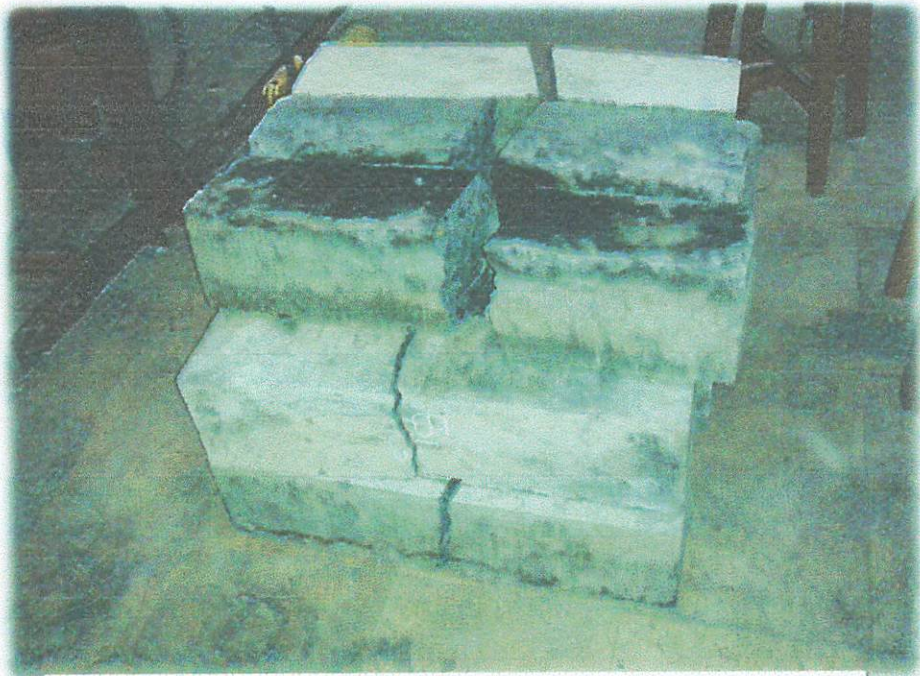
Letak Keruntuhan Pada Balok Beton
