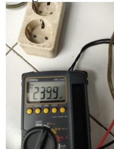
Gambar. 13. Pengukuran Multimeter Tegangan
