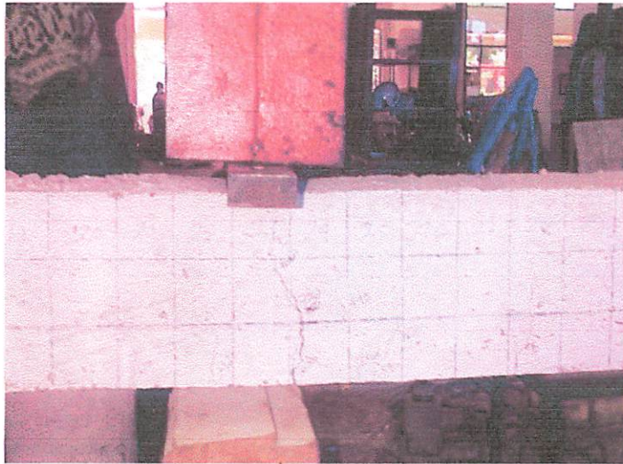
Gambar 4.7 Pola retak balok tanpa sambungan (BTS)-B
