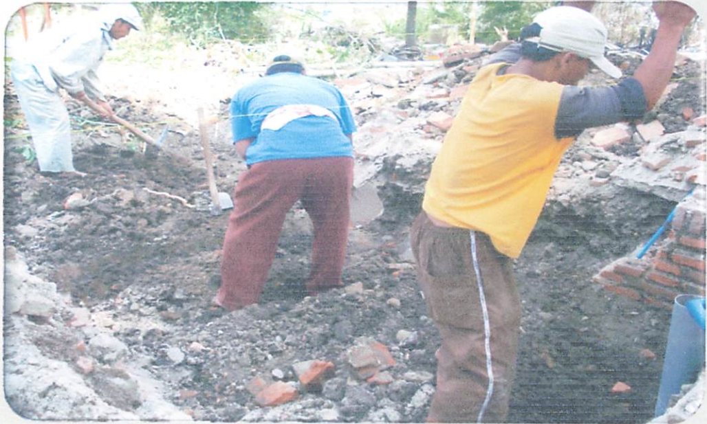
Tgl September 2011 Lokasi studi Perumahan Rimba Karya / Tulungagung Kegiatan : Tahapan Pertama Penggalian Pondasi perumahan
