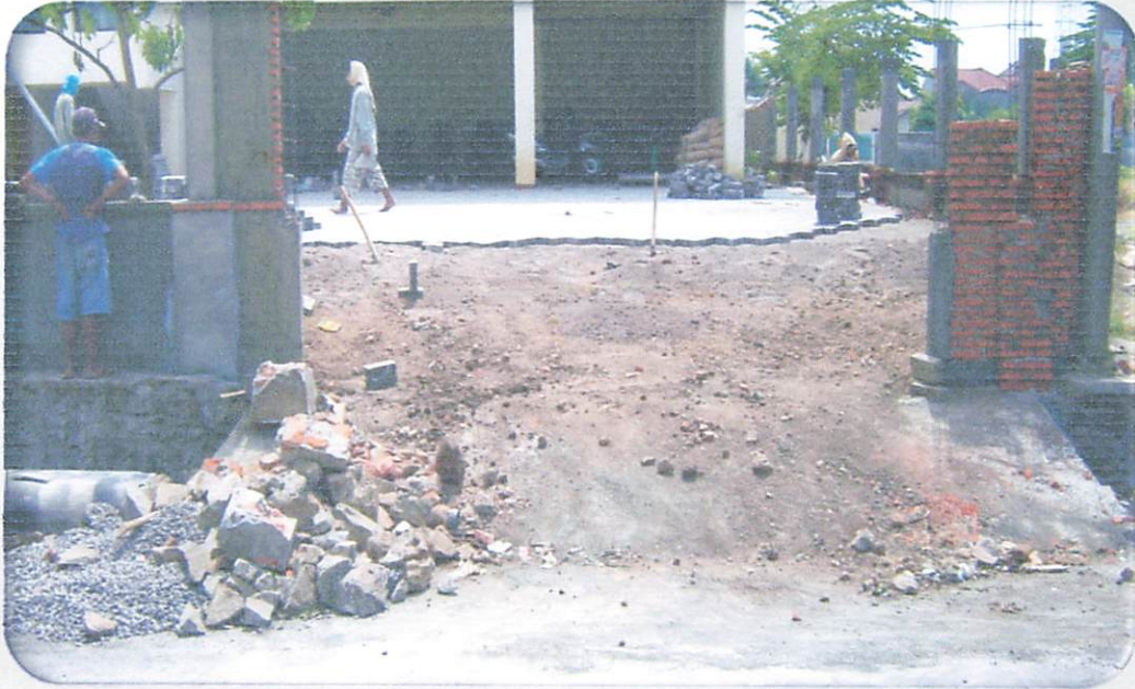
Tgl 27 November 2011 Lokasi studi Perumahan Rimba Karya / Tulungagung Kegiatan : Tahapan Pembangunan Pagar perumahan
