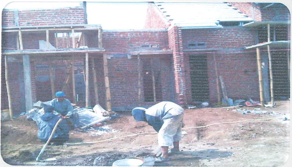
Tgl September 2011 Lokasi studi Perumahan Puri Permata / Tulungagung Kegiatan : Pencampuran bahan bangunan, serta memberikan pertanyaan kepada responden (tukang batu)
