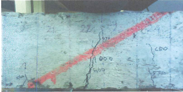
Gambar 4.9. Pola retak balok dengan jarak sambungan beton dan tulangan seper-dua (1/2-A) bentang
