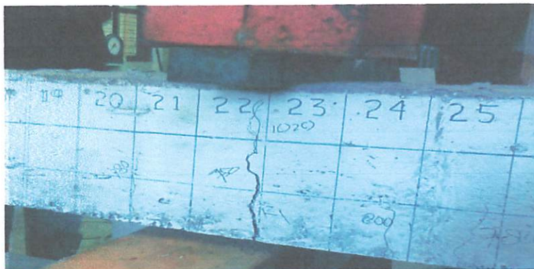
Gambar 4.6 Pola retak balok tanpa sambungan (BTS)-A
