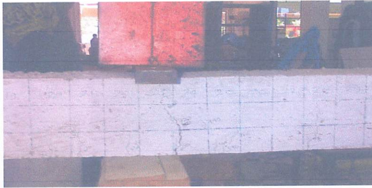
Gambar 4.7. Pola retak balok tanpa sambungan (BTS)-B
