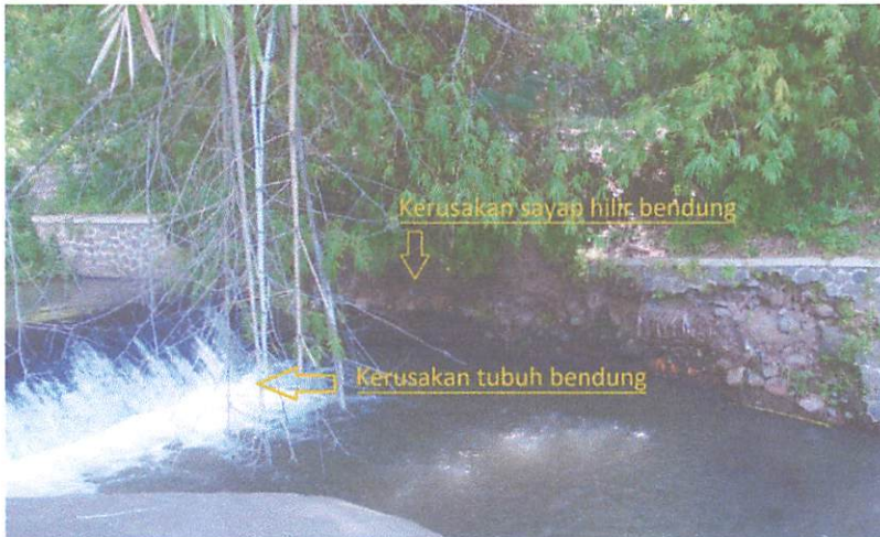
Gambar 1.1 Kerusakan tubuh bendung dan sayap bendung
