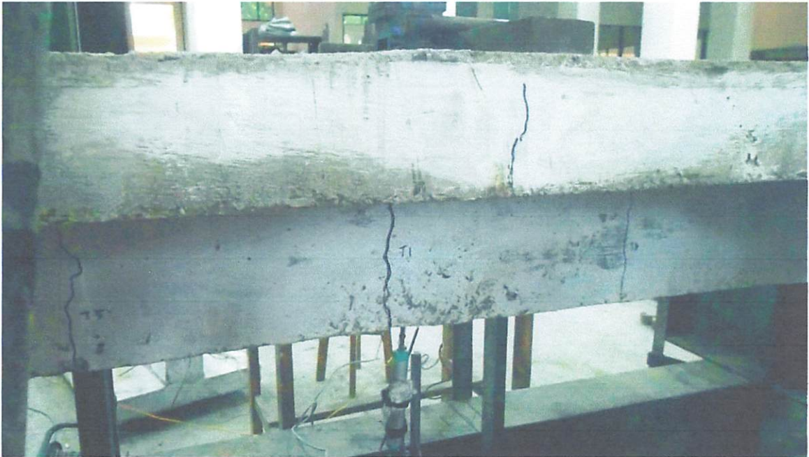
Foto 4.14 Pola retak balok T tanpa sambungan ( BTS ) B
