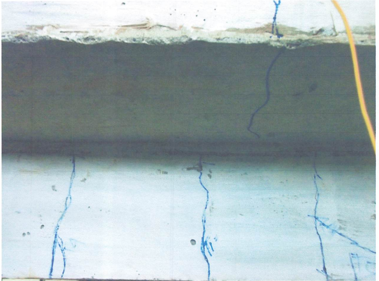
Foto 4.17 Pola retak balok T dengan jarak sambungan beton dan tulangan seper – dua ( \frac{1}{2} ) B bentang
