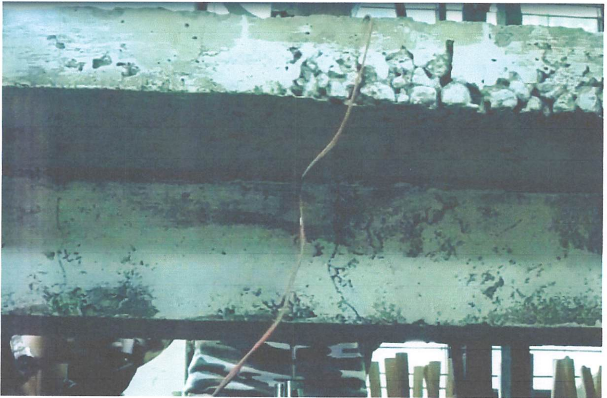
Foto 4.2 Retak yang terjadi pada balok T tanpa sambungan A ( BTS-A )
