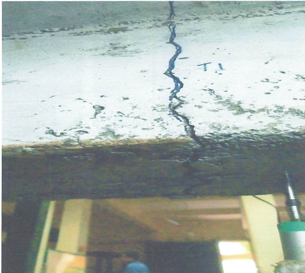
Foto 4.15 Pola retak balok T tanpa sambungan ( BTS ) C
