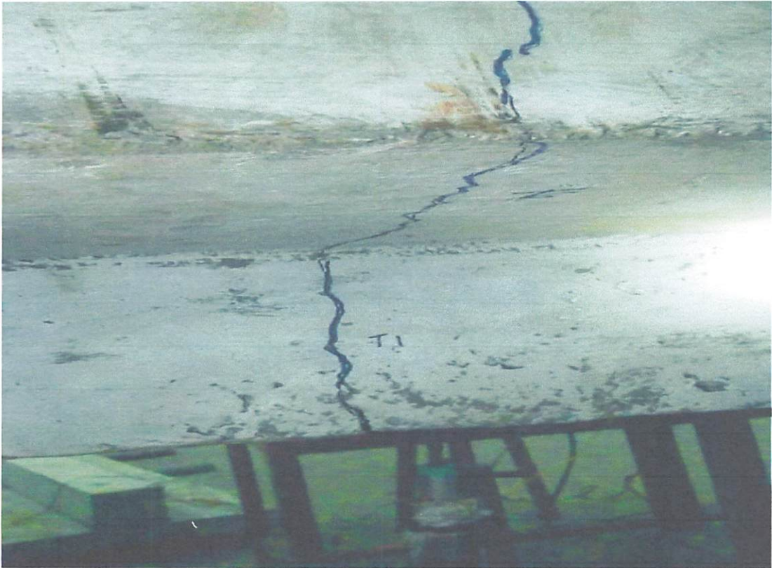
Foto 4.13 Pola retak balok T tanpa sambungan ( BTS ) A
