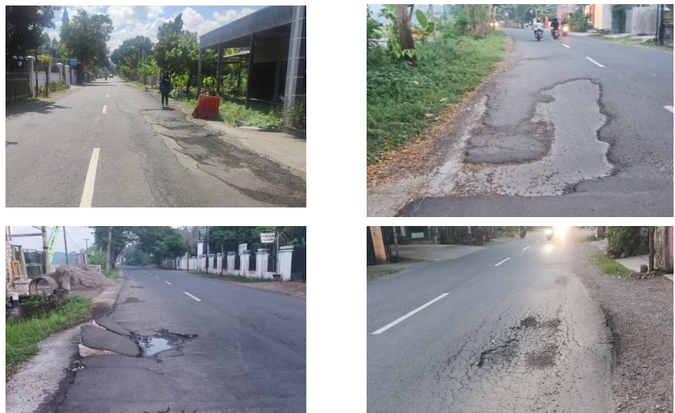
Gambar 1. 1Kerusakan pada Ruas Jalan Ngampon-Bendo
