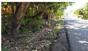
Gambar 4. Contoh Kerusakan Penurunan Bahu
