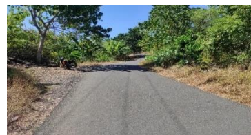
Gambar 3. Contoh Kerusakan Bekas Roda
