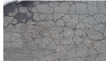
Gambar 1. Contoh Kerusakan Retak
