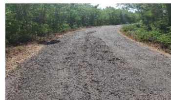
Gambar 2. Contoh Kerusakan Lubang
